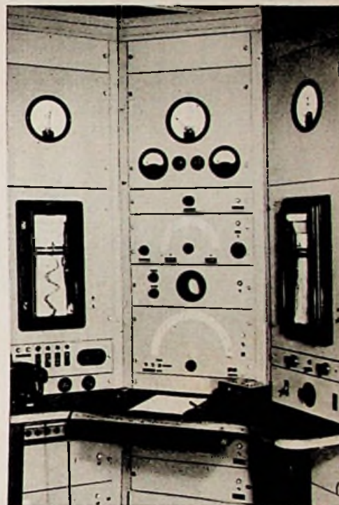
Abb. 3. Mittelwellenfrequenzmeßplatz mit Doppelrückmischsuper und Hilfsoszillator. Mit Schreibern werden Gleichwellenschwebungen registriert
